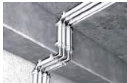
Mocowanie przewodów izolowanych
