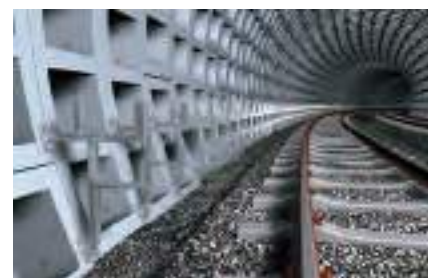
Instalacje w tunelach
