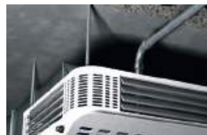
Podwieszenie urządzeń klimatyzacyjnych
