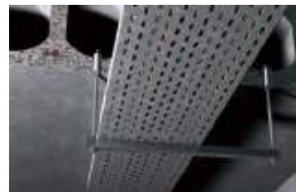
Trasa kablowa mocowana do płyt kanałowych
