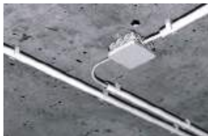
Mocowanie przewodów izolowanych
